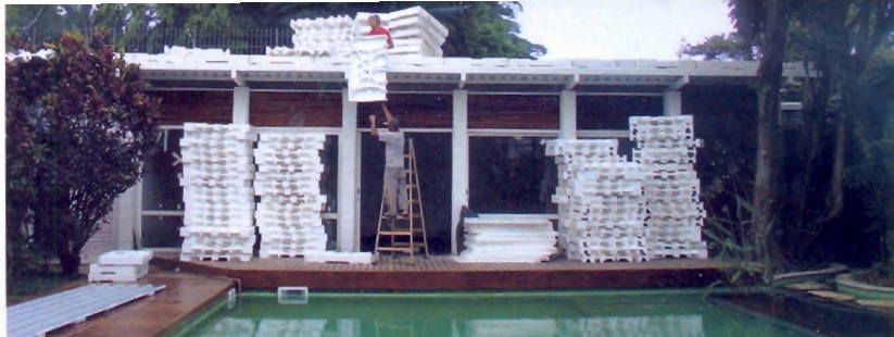
Estruturas reforçaram a edícula e placas de isopor diminuíram o peso do substrato
